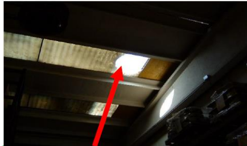
Foto 2: lucernario sfondato visto dal magazzino sottostante
